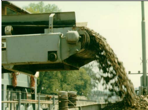
Bild 20.2 Anwendungsbeispiel für die Betriebsart S6-60 %: Trommelmotor zum Abtransport des diskontinuierlich geförderten Aushubs eines Schwimmbaggers
