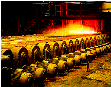
Bild 47.1.1 Aufsteck-Rollgangs-Getriebemotoren an einem Arbeitsrollgang
