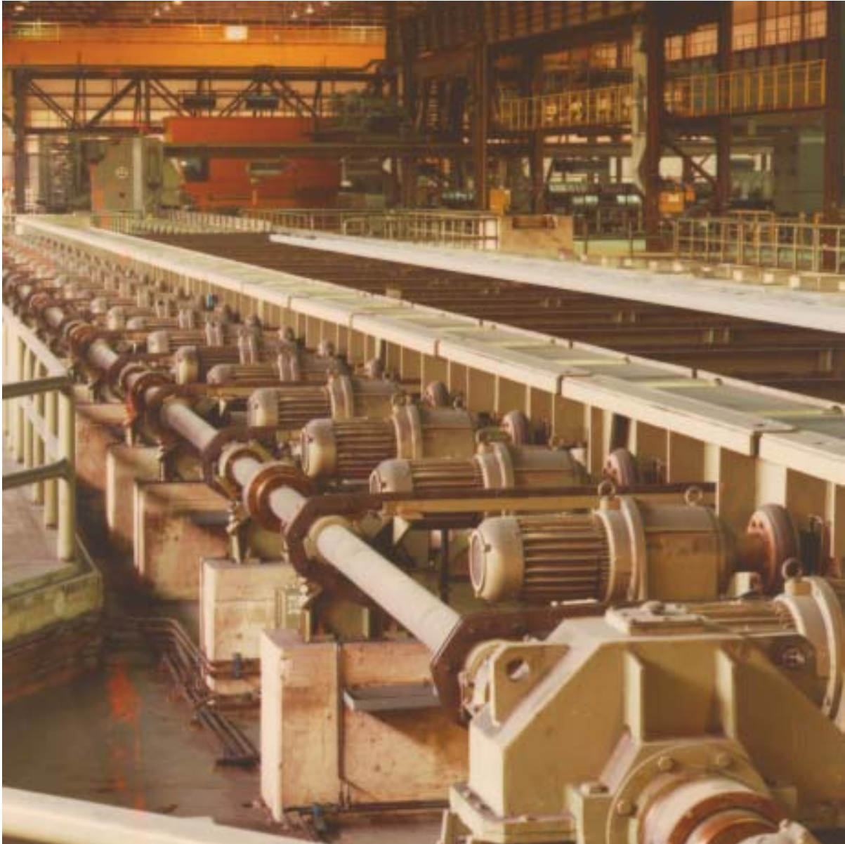
Bild 1.3 Frequenzgesteuerte Rollgangantriebe in den Stahlwerken Peine; Inbetriebnahme 1977
