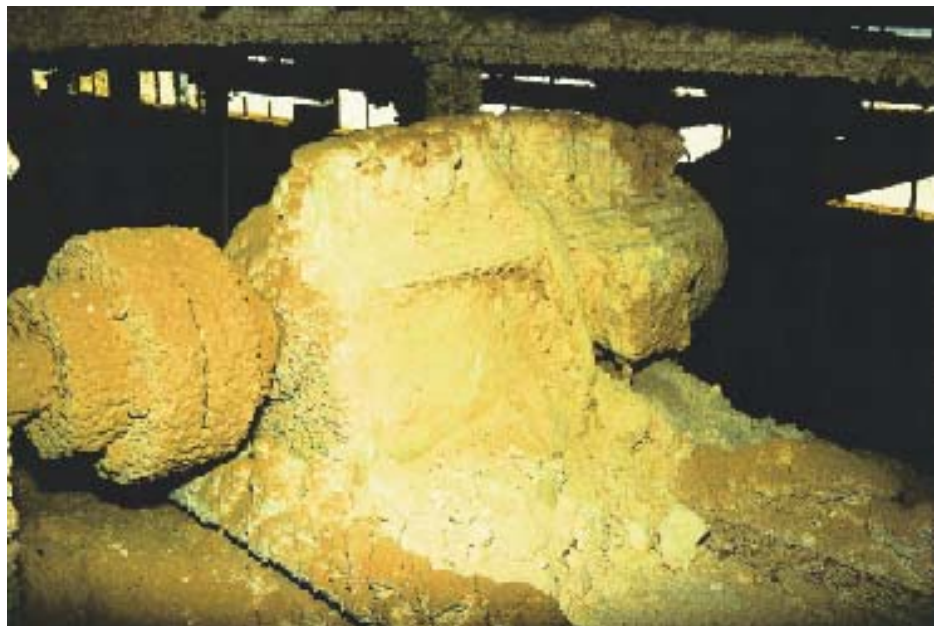
Bild 24.5.3 Getriebemotor mit unzulässig hoher Staubauflage in einer Mälzerei
