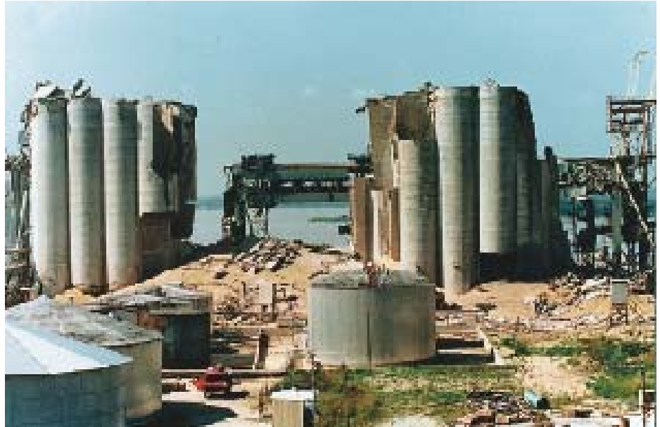
Bild 18.1 Silo-Explosion bei SEMABLA, Blaye, Gironde (1997) Foto: VSD
