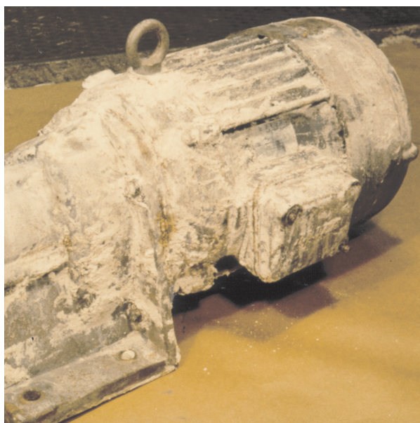
Bild 5.4.2.3 Verschmutzte Kühlrippen erhöhen die Erwärmung
